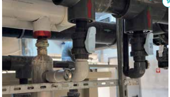
MIEJSCE WPROWADZENIA WODY ZAOZONOWANEJ DO INSTALACJI CYRKULACJI - BASEN PŁYWACKI
