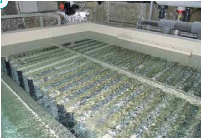
FILTR PODCIŚNIENIOWY W TRAKCIE FILTRACJI
