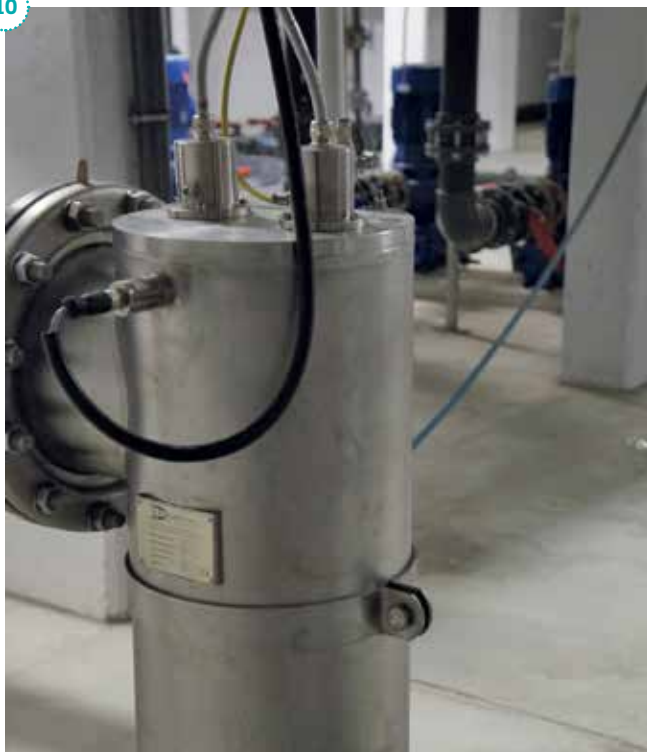
REKTOR UV W INSTALACJI CYRKULACJI WODY DLA BASENU PŁYWACKIEGO
