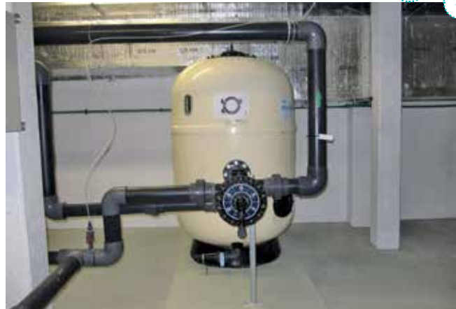
FILTR CIŚNIENIOWY W OBIEKCIE DLA BRODZIKA
