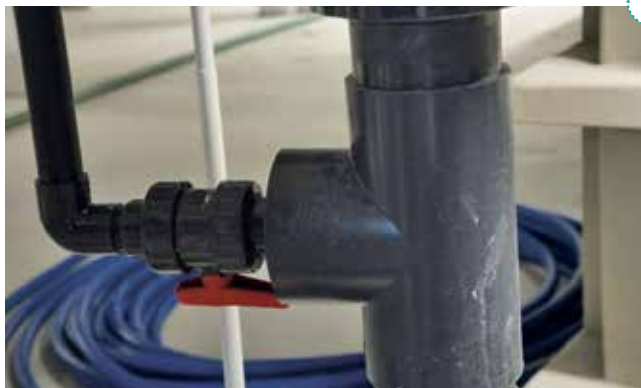
◆ MIEJSCE POBORU WODY DO OZONOWANIA – BAsEN PŁYWACKI
