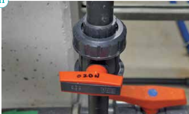
ZAWÓR DO WPROWADZENIA WODY ZAOZONOWANEJ W INSTALACJI OCZYSZCZANIA WODY W BRODZIKU
