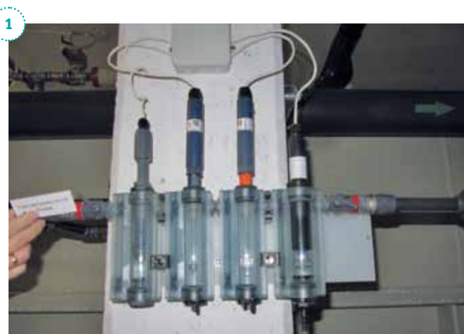
1 WIDOK ZESPOŁU ELEKTROD POMIAROWYCH DLA WODY Z NIECKI BAsENU
